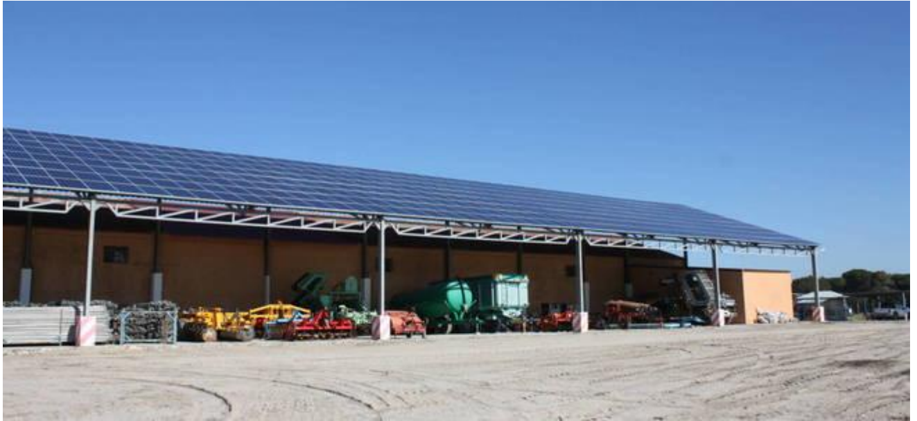
Una instalación fotovoltaica con eólica en Olmedo, Valladolid. (R. M.)
