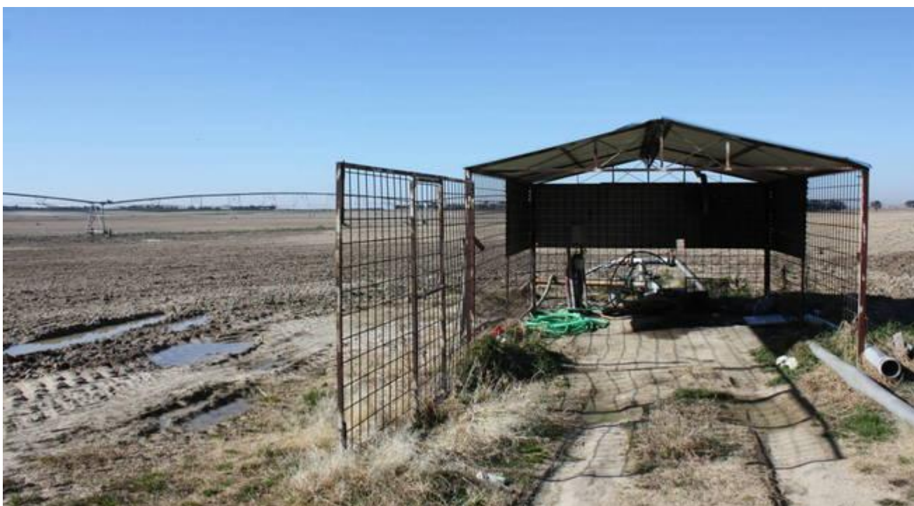
Un pozo que usa la energía fotovoltaica para bombear agua. (R. M.)
